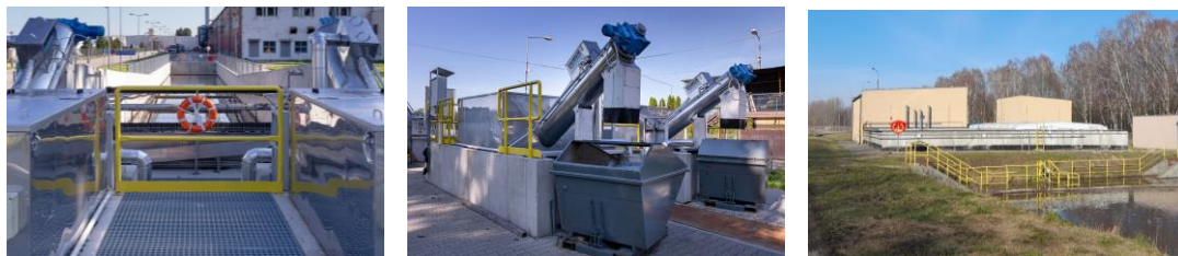
Oczyszczalnia wód opadowych i roztopowych w zakładzie Woodeco Wieruszów i Woodeco Grajewo.
